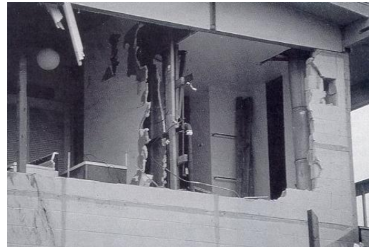
(d) Collapse of masonry wall (HUD, 1993)
