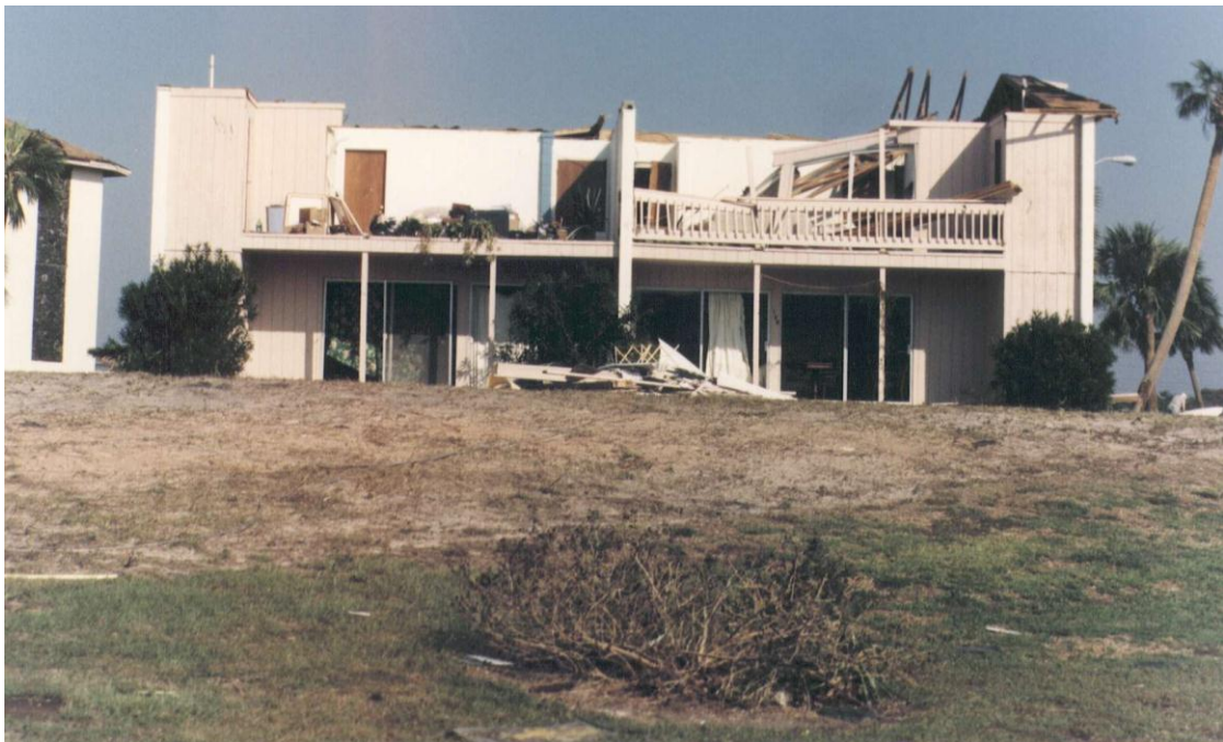
(d) Whole Roof Failure, Wall Failure
